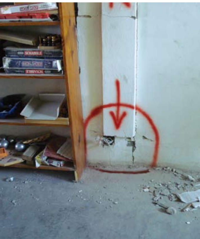
Carencia de continuidad en columnas presentes en la estructura del Centre de Lectura y D'Animation Culturelle. CORTESÍA DPAAE
