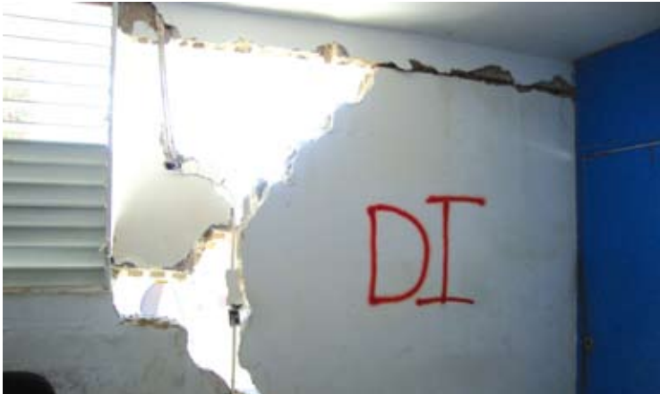
Colapso parcial en muros de cerramiento perimetral de la Comisaría de Cabaret. CORTESÍA DPAE
