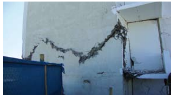
Daños en el muro del costado sur de la segunda torre del proyecto. CORTESÍA DPAE
