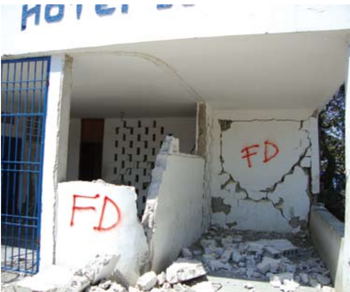
Vista del acceso al edificio de la Alcaldía de Cabaret, evidencia de agrietamientos diagonales en muros. CORTESÍA DPAE
