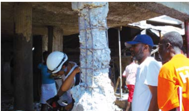
Deficiencias constructivas en columnas de la estructura del Marche - Cabaret. CORTESÍA DPAE
