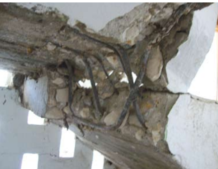
Detalle refuerzo en escaleras de acceso al segundo nivel de la Alcaldía de Cabaret. CORTESÍA DPAE
