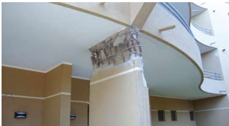
Daño en muro perimetral de pequeña sección transversal de la Torre Sur del Conjunto Bosquemar. CORTESÍA DEPAE
