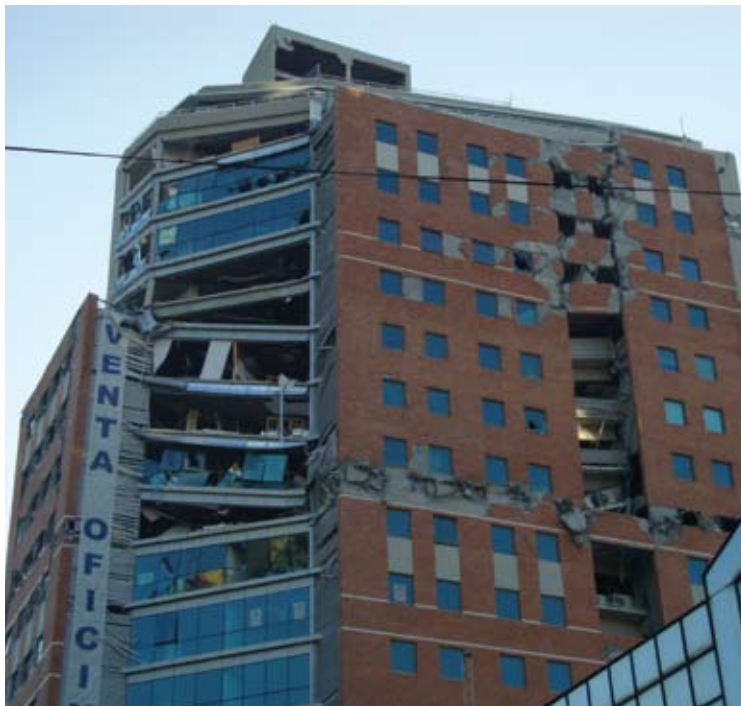
Detalles de los daños sufridos en los pisos altos de la Torre O'Higgins. Se evidencia la desaparición del nivel 12 y daños severos e irreparables en los muros estructurales de los pisos altos de la edificación. CORTESÍA DPAE
