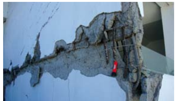
Detalles de los daños sufridos en el muro del cortante del costado sur de la segunda torre del proyecto Olas. CORTESÍA DPAE
